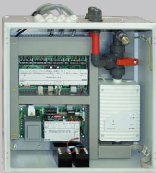
System-Zentrale LSC 44 / notstromversorgt
